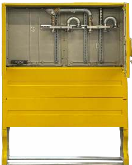
szafa gazowa SSTG 106x58+FTG 106x84 na 2 gazomierze w poziomie
